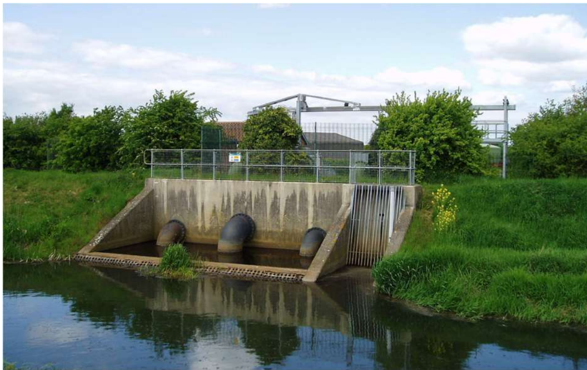
Slika 2-53 Primjer crpne stanice
