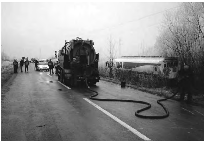
Slika 7.1.4. Prevrtnanje cisterne - sanacija
